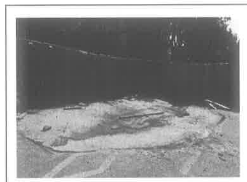
5.市政道路塌陷处
