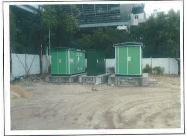
图 2. 地块内施工用电已安装
