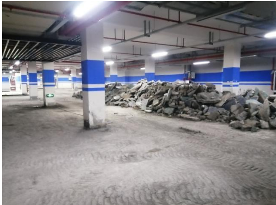
1、一期地下室维修现状
